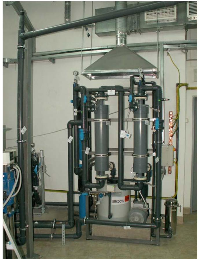
在冰宫采用Liqui-Cel®脱气水处理装置制取完全透明的大型冰场
